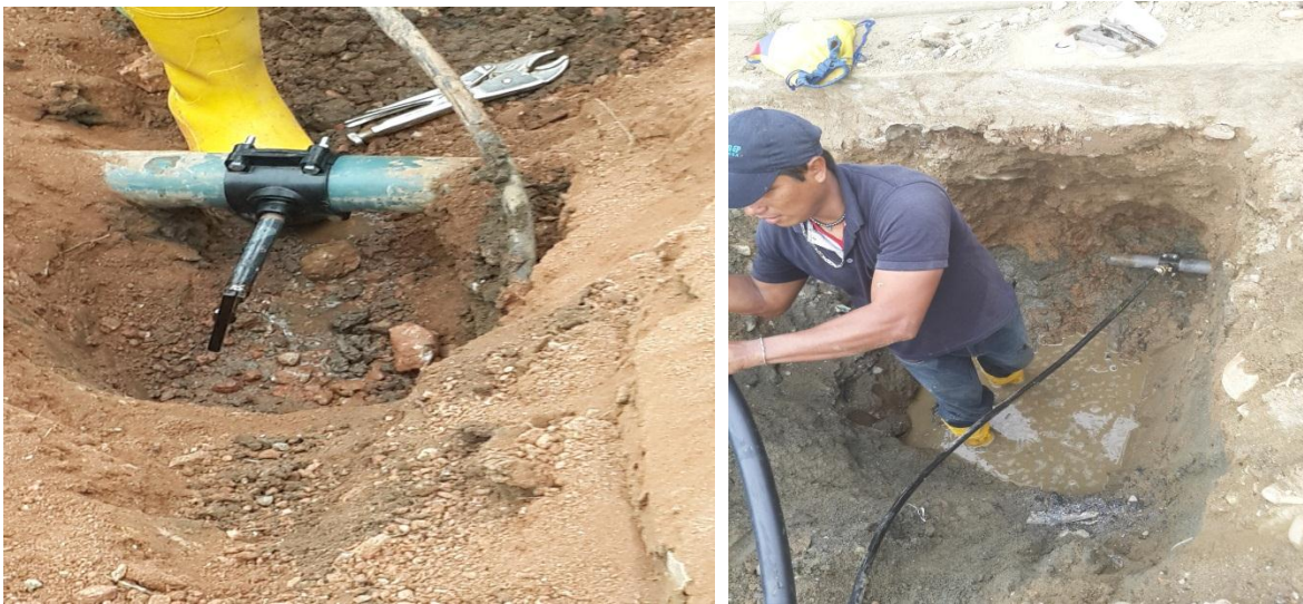
Perforaciones en tubería madre en acometidas nuevas de diferentes diámetros de 110mm y de 63mm
