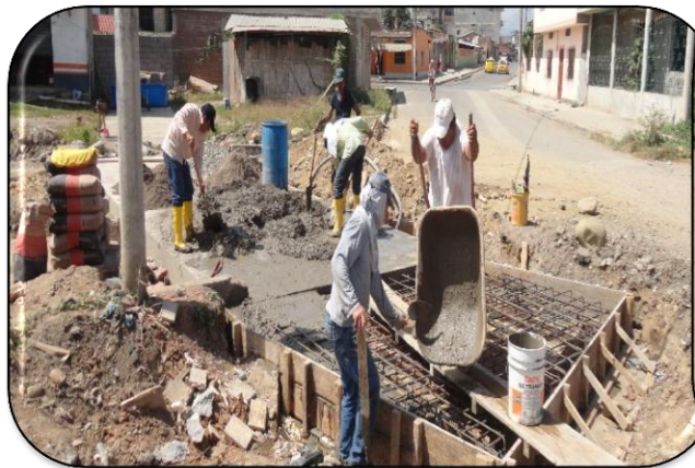
Alcantarilla tipo cajón
